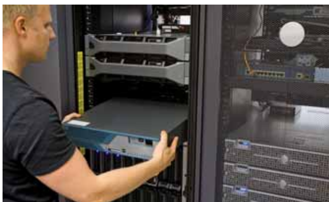
Aufbau von aktivem Equipment in der Kopfstelle
