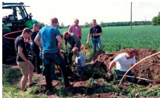
Die Landwirte in Sendens Außenbezirken packen selbst mit an und verlegen die Glasfaser in Eigenregie bis zu ihren Höfen
