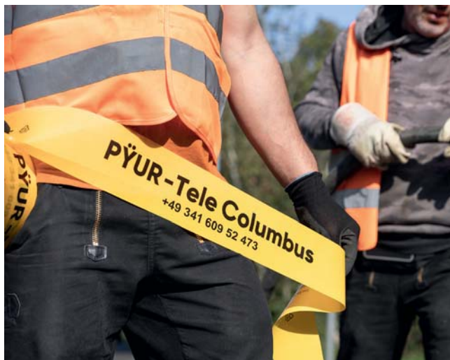
28 DAA-Ausbau in Berlin
