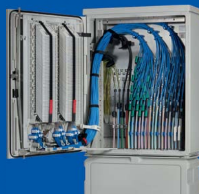
Glasfaser-Netzverteiler EK245 L 2.6
