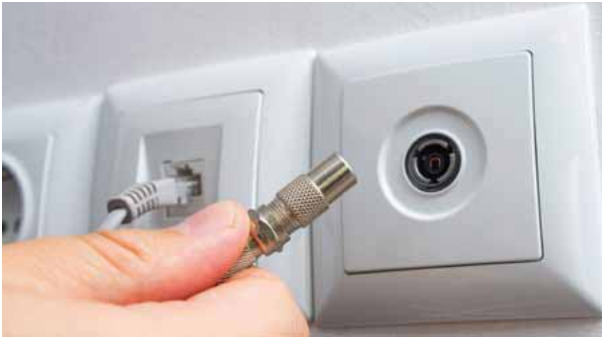
Die Glasfaser ist sicherlich die Technologie der Zukunft. Das bewährte Kabel kann den steigenden Breitbandbedarf jedoch auch decken.
