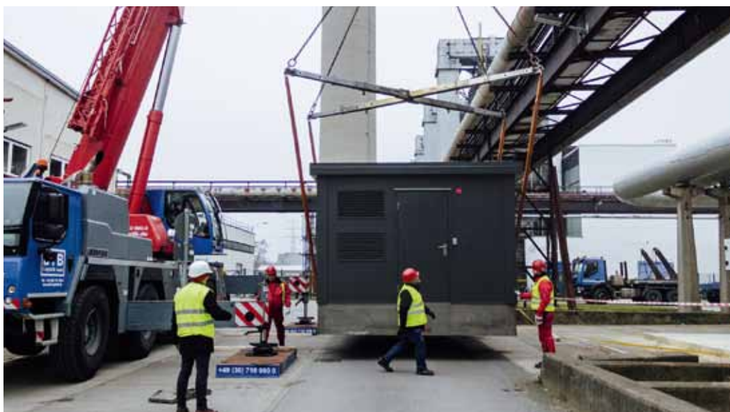
Der erste der Points of Presence (PoP), hergestellt vom dänischen Hersteller Priess A/S, wurde im Dezember durch den Distributor und Systemintegrator ANEDiS auf dem Kraftwerksgelände der Vattenfall Wärme AG in Berlin errichtet. Er nahm im Februar 2023 seinen Betrieb auf. Dieses Jahr werden noch vier weitere baugleiche PoPs an verschiedenen Standorten folgen.
