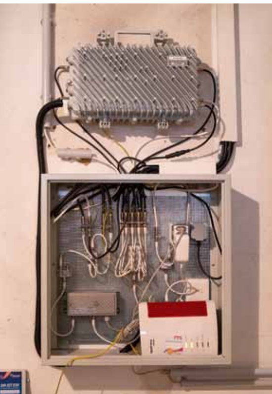
Installierter Remote-CCAP-Node und geöffneter Verteilschrank
