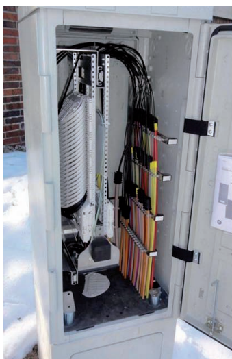
GF-Verzweiger im KDG-Netz
