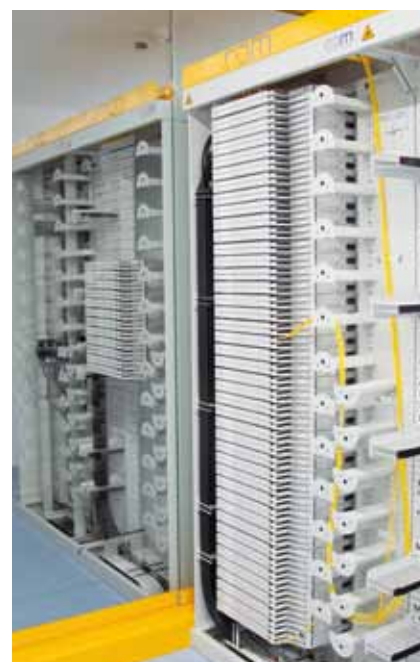
Das Herzstück des MOKO-Rechenzentrums mit CARMA ODF-Racks inkl. Kabelkanalsystem, SLITE LWL-Patchpanels und Patchkabel von Connect Com
